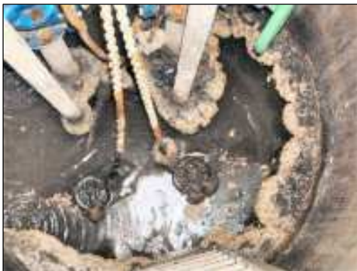
Bild 2. Abwasserpumpwerk nach AWAkon3 © Anwendung Abbau der Fettablagerungen, die Neubildung wird verhindert
