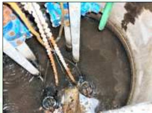
Bild 1. Abwasserpumpwerk vor der Produktanwendung Fettablagerungen führen zu Betriebs- und Geruchsproblemen, sowie zu erhöhtem Wartungsaufwand. Die Korrosion der Abwasseranlagen wird gefördert
